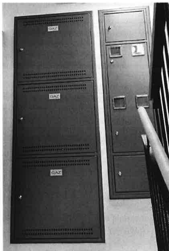
Drzwiczki szafek energetycznych – fot. pogładowa
